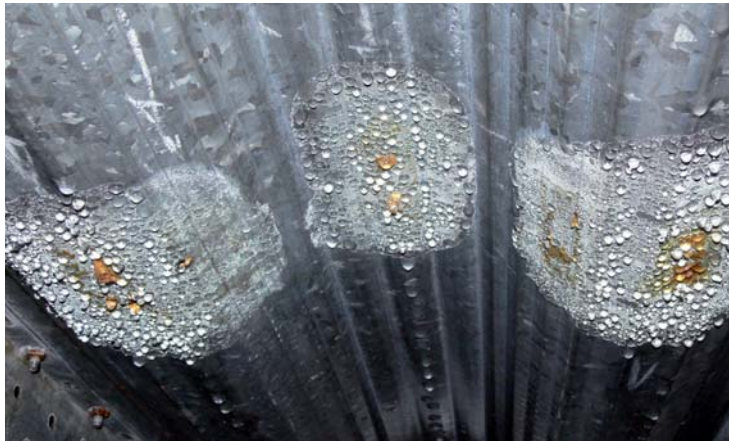
Koroze a degradace konstrukcí vlivem kondenzace vlhkosti
